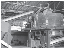
Im Kollergang wird das Rohmaterial zerkleinert und aufbereitet.
